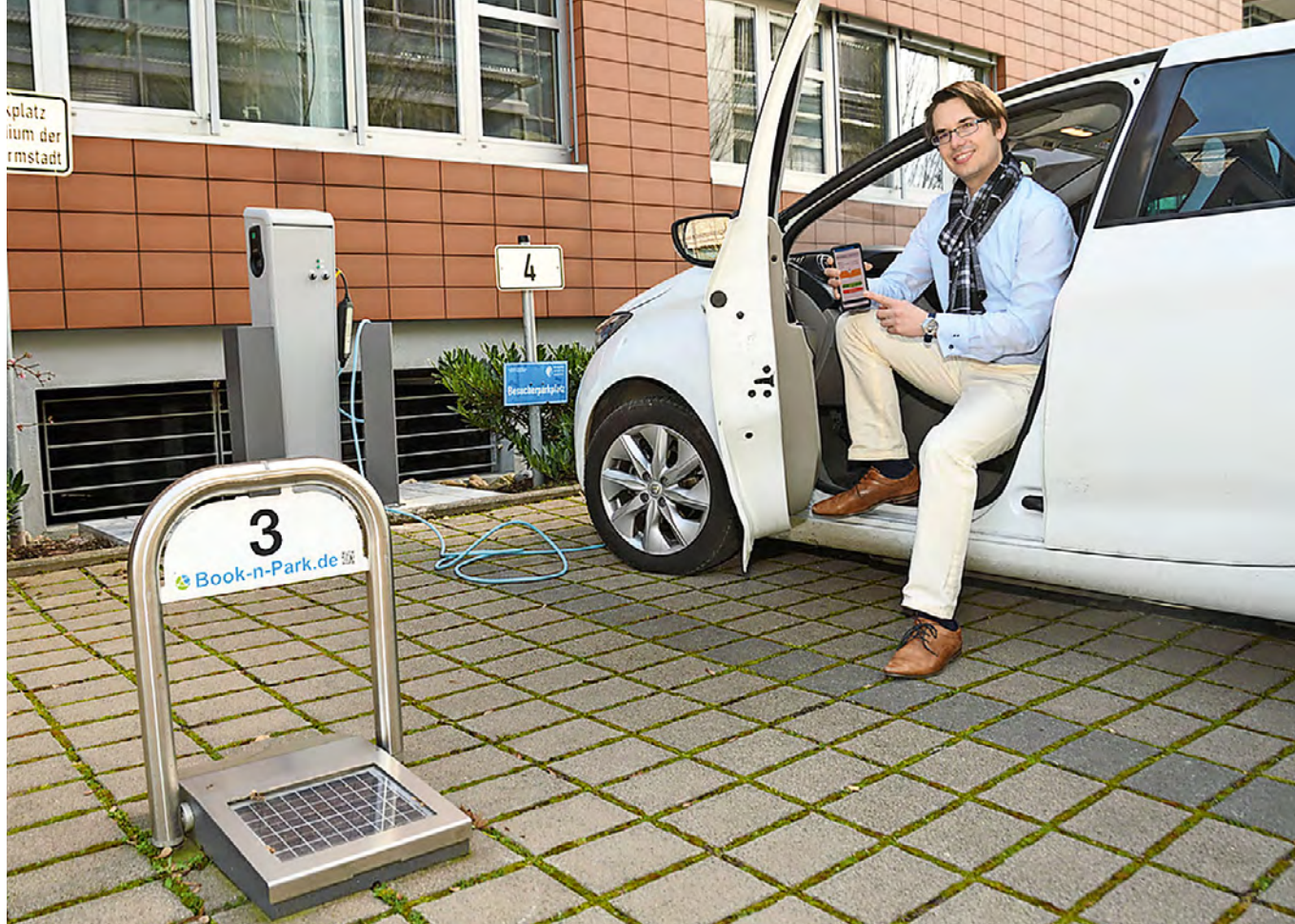
Immer mehr Ladesäulen werden mit digital gesteuerten Parkbügeln von Book-n-Park gesichert. Geschäftsführer Mathias Hornjak von Green Mobility Solutions demonstriert die komfortable Bedienung am Smartphone.
