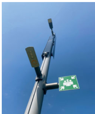
mast have BY FONATSCH inkl. Photovoltaik und Notbeleuchtung
