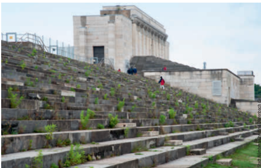
Blick auf den Mittelbau der Zeppelintribüne. Die Stufenanlagen und steinernen Verblendungen sind vielfach beschädigt. Im Sommer sprießt aus vielen Fugen Unkraut.
