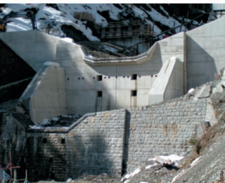
Hochwasserschutzbauten (wie hier in Salzburg) müssen gepflegt und Instand gehalten werden!
